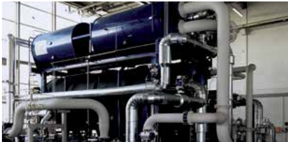
Pompe à chaleur
